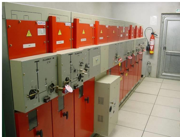
Intérieur d'un poste de livraison
